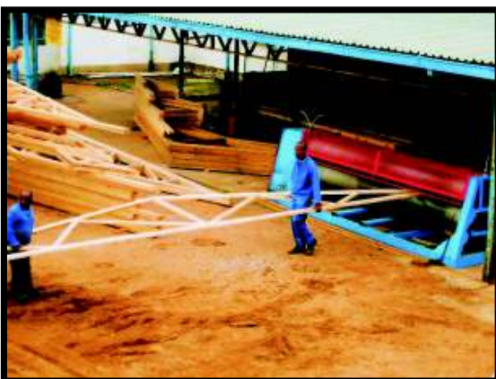
Truss Roller Press
